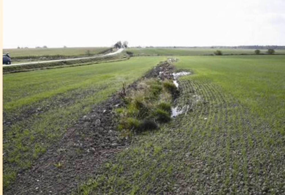
Vodní eroze zemědělské půdy způsobená vývěrem drenážních vod na povrch území v místě poškození svodného drénu.
